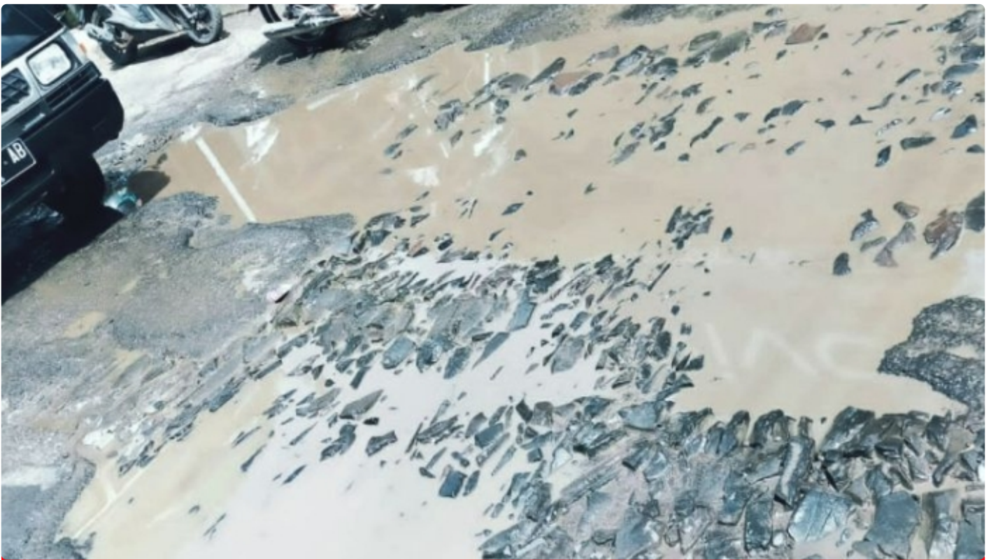
Terlihat jalan protokol Malingping rusak dan digenangi air
