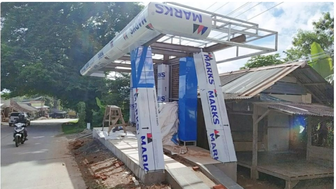
Halte di depan RSUD Malingping yang diduga terlantar pengerjaannya
